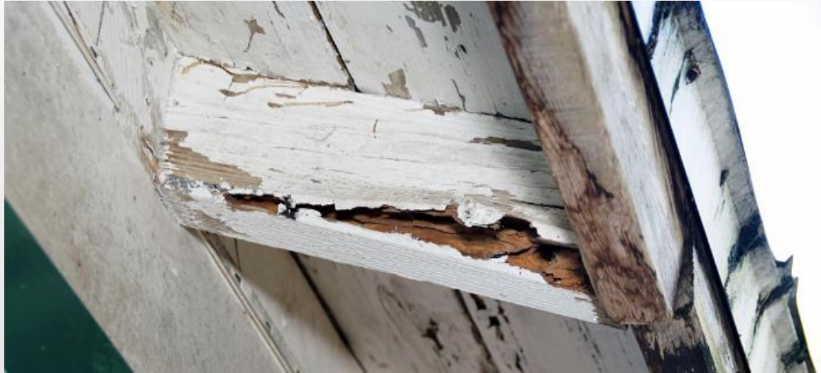
Wet rot soffit
